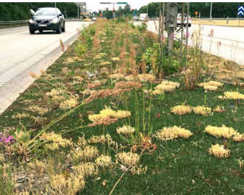
Konstgräs används inte bara till fotboll utan även som ett skötsel-fritt material på svåråtkomliga ytor i trafikmiljö, som här vid Dalbyvägen, den östra infarten till Lund, där cirka 12 000 fordon passerar varje dygn. Konstgräset är anlagt omkring 2008 och började redan efter ett par år att växa igenom av ogräs. Det är svårt att rensa ogräs mekaniskt eller på annat sätt utan att skada konstgräset och ytan har varit skötsel-fri (=inte skött) under de tio år som gått sedan den anlades.
