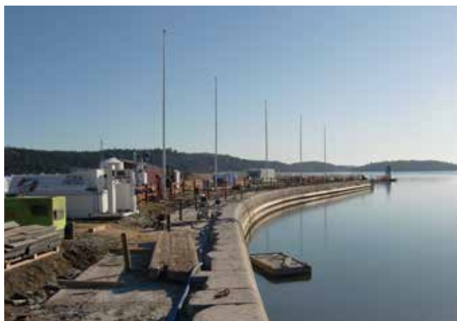
I Göta kanal används miljöspont som kvarsittande form vid injektering av stenkista. Samtidigt utgör sponten ett långsiktigt skydd för kajen.
