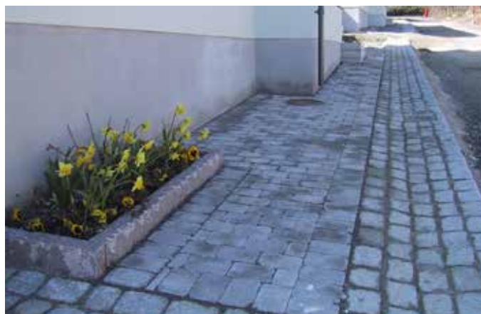
Anläggning av trottoar, rännal i gatumiljö där den viktiga inspänningen skapar en hållbar konstruktion.
